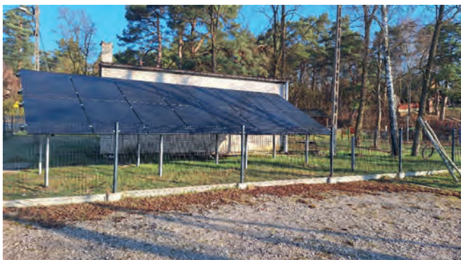
Instalacja fotowoltaiczna na terenie świetlicy wiejskiej Vera w Zakościelu
