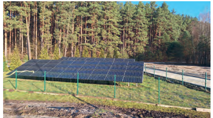
Instalacja fotowoltaiczna przy oczyszczalni ścieków w Zakościelu
