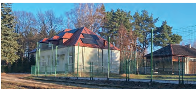
Instalacja fotowoltaiczna na budynku świetlicy wiejskiej w Liciążnej
