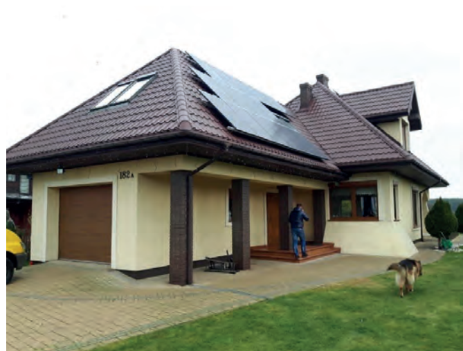
Instalacja fotowoltaiczna zainstalowana na budynku jednorodzinnym
